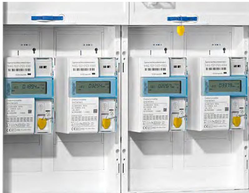
Die neue VDE-AR-N 4100 ist am 1. April 2019 in Kraft getreten.
