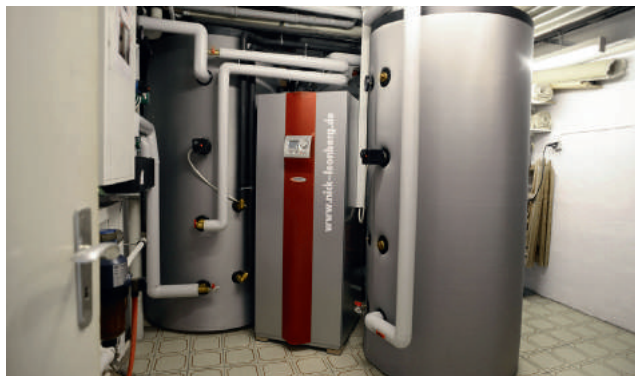
Wärmepumpen gewinnen für das E-Handwerk ebenfalls an Bedeutung.
