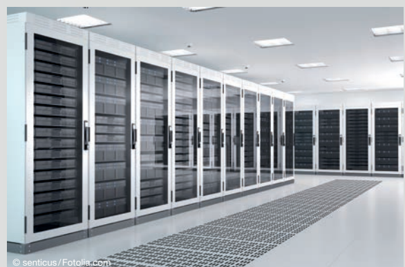
Vorausschauende Lösungen sind vor allem in Serverräumen oder Rechenzentren gefragt, um Energieeinsparungen von bis zu 75 Prozent erreichen zu können.
