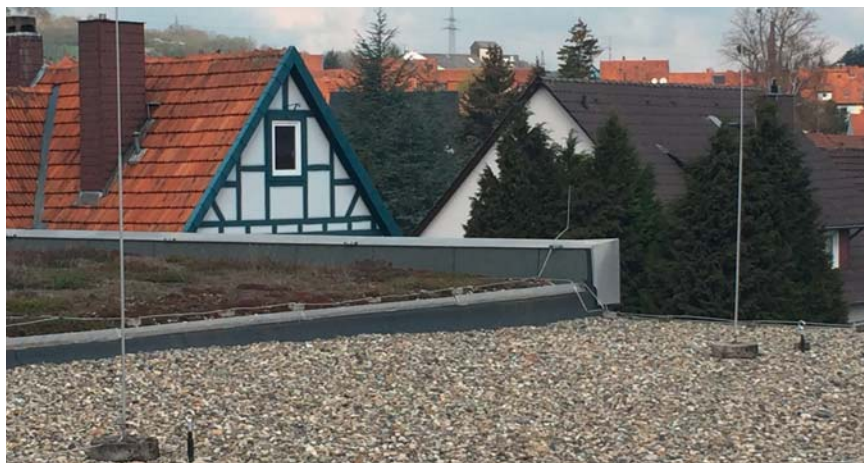
Gutes Beispiel für den äußeren Blitzschutz: Fangeinrichtung auf einem Zweckgebäude.
